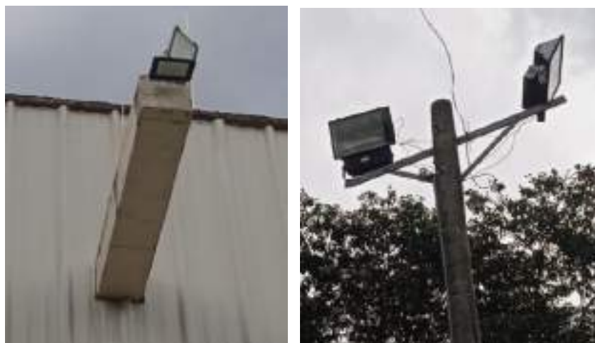
Figura 70. Reflectores y cámaras de seguridad en el campus de la facultad
